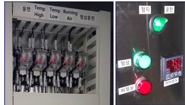
5. Burning Air Flow 센서가 감지되면 정상운전 상태가 된다. <정상 운전 조건> 운전 스위치 ON, 정상 온도(730~900℃), Burning Air Flow
