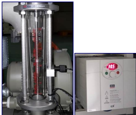
4. Heater 온도가 Low Alarm값(730℃) 이상으로 승온되면 Inverter에 의해 Blower가 동작하여 Burning Air가 공급된다.
